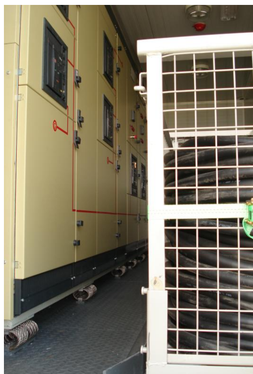
TGBT sur amortisseurs (suspendu) Caisse de rangement des câbles
