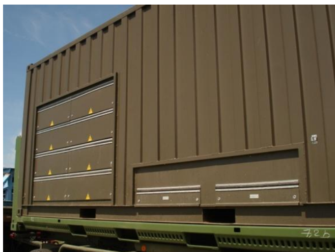
Trappes de raccordement du TGBT
