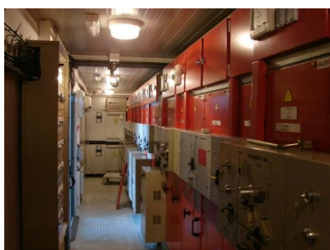
Poste répartiteur HT
